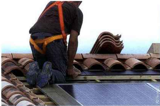
Le système Lahe-Roof récupère les calories sous les tuiles et préchauffe l'air pour la pompe à chaleur.
