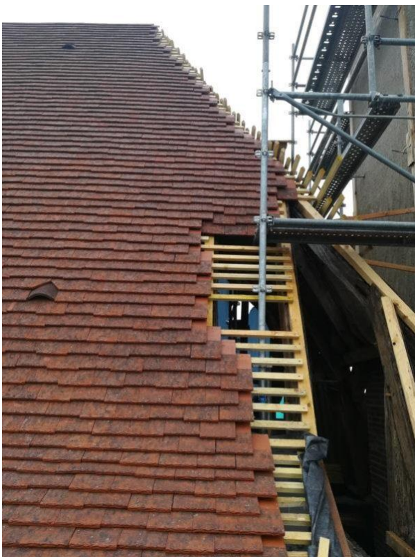
Rénovation de la charpente du pavillon Ouest – ©Mairie de la Salvetat Saint-Gilles
